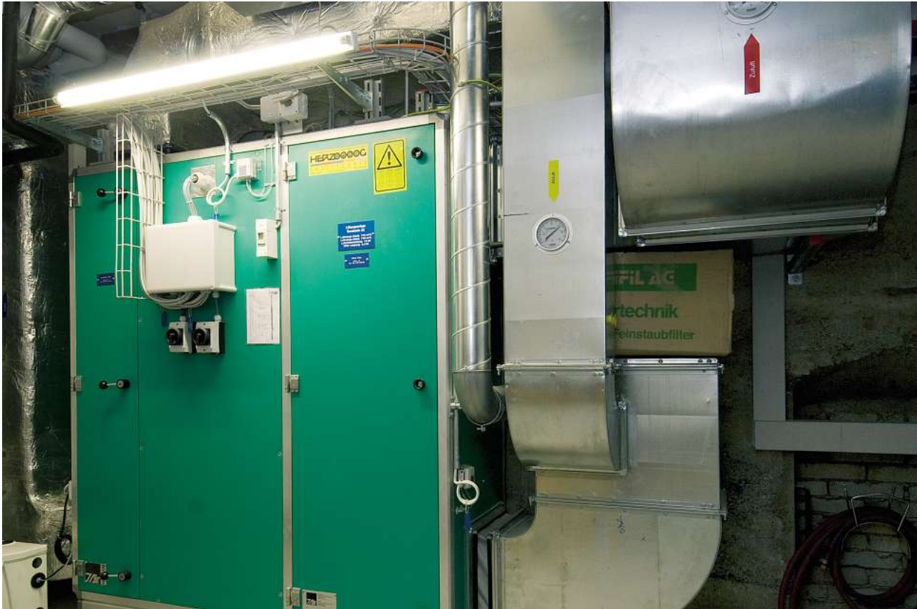
Monoblock (Lüftungszentrale) Lüftung Untergeschoss
