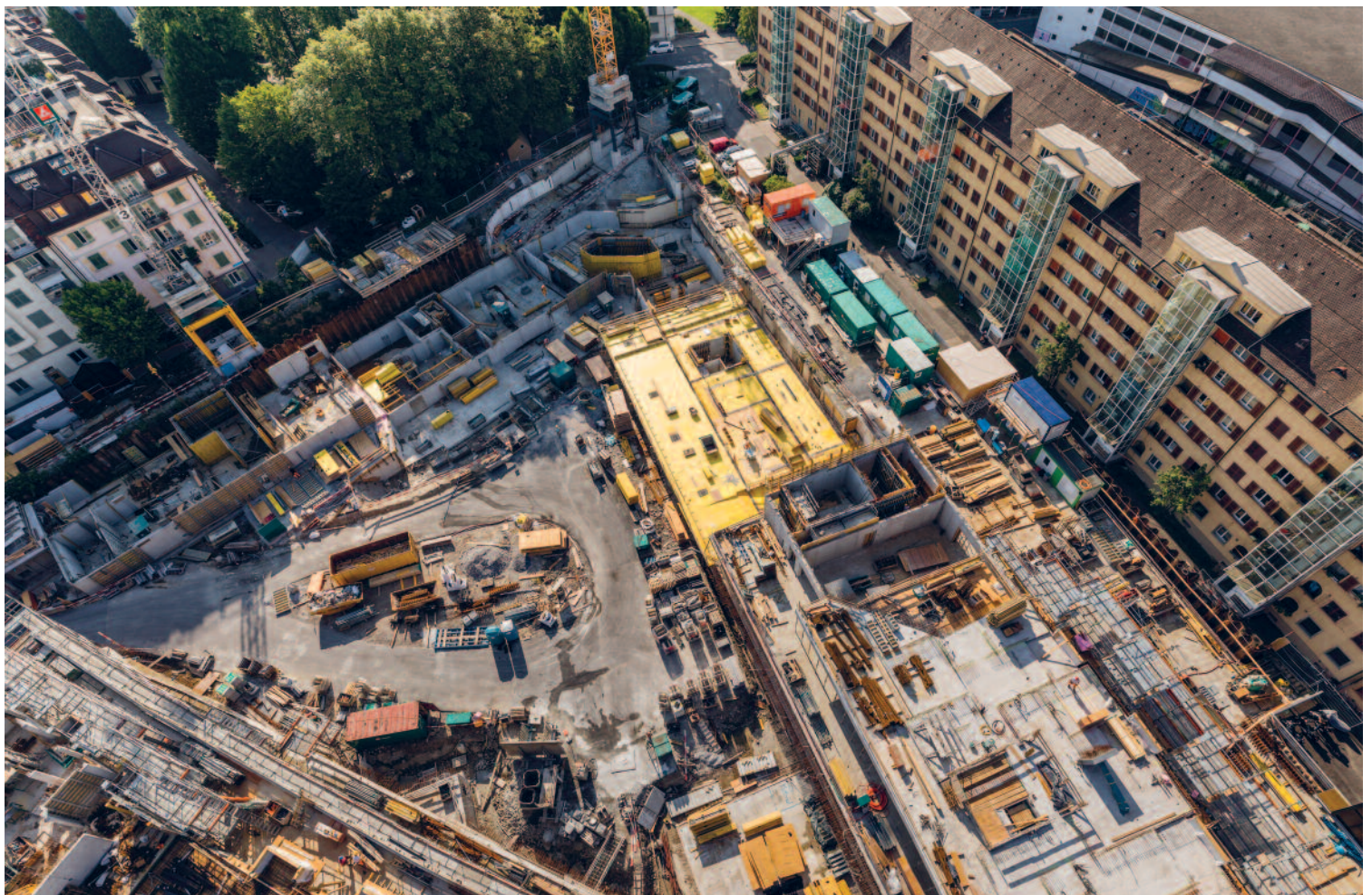
Oben: Entspannt, konzentriert und sichtlich zufrieden: Kranführer Max Estermann. Unten: Totale Übersicht auf die Baustelle Himmelrich 3.
